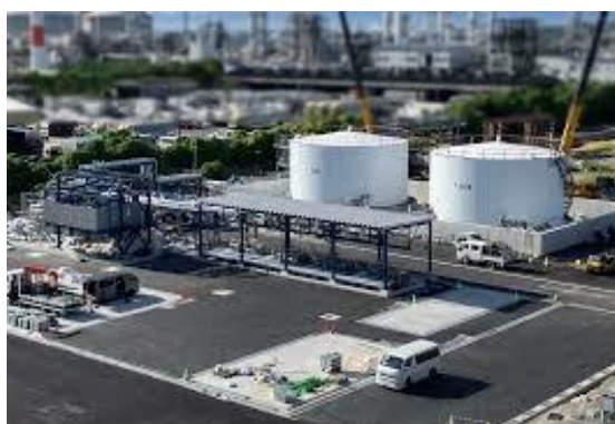
SAF の原料となる廃食用油受け入れ施設
